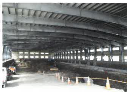
B棟建屋内
